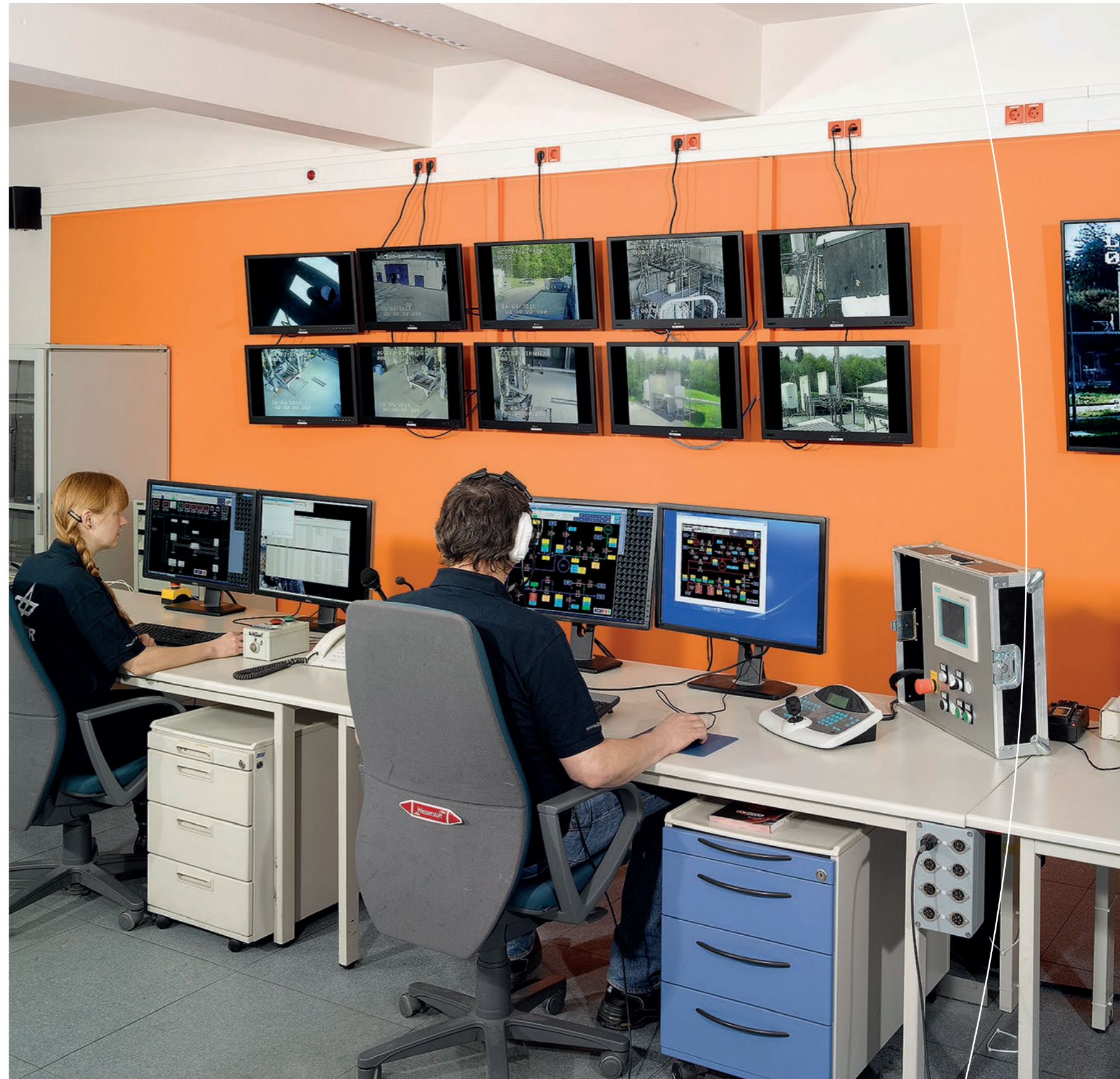
Im geschützten Kontrollraum liegt die Verantwortung für die Tests im Raketenmotorenprüfstand P8 des DLR. Draußen ist im Umkreis von einhundert Metern alles gesperrt.
